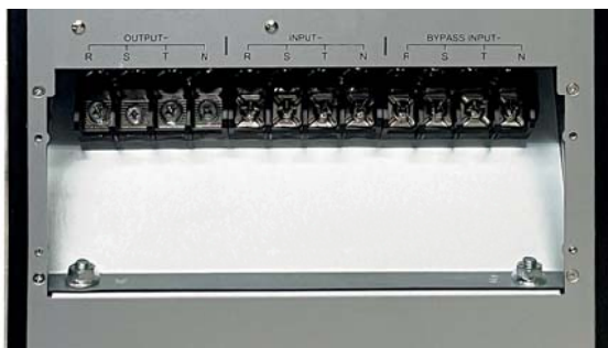
Block de terminales entrada/salida
